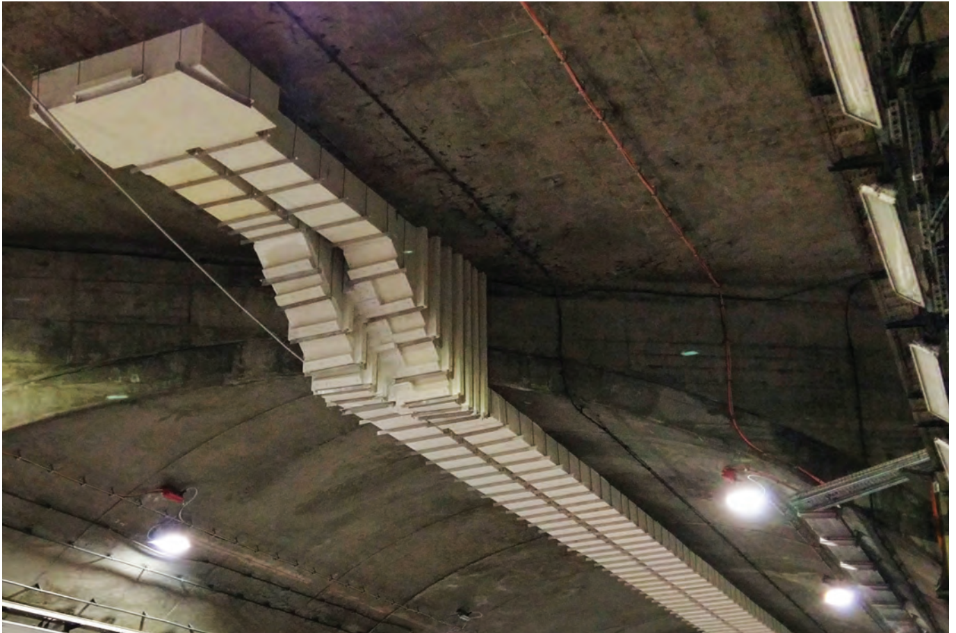
Kabelkanal mit Funktionserhalt
